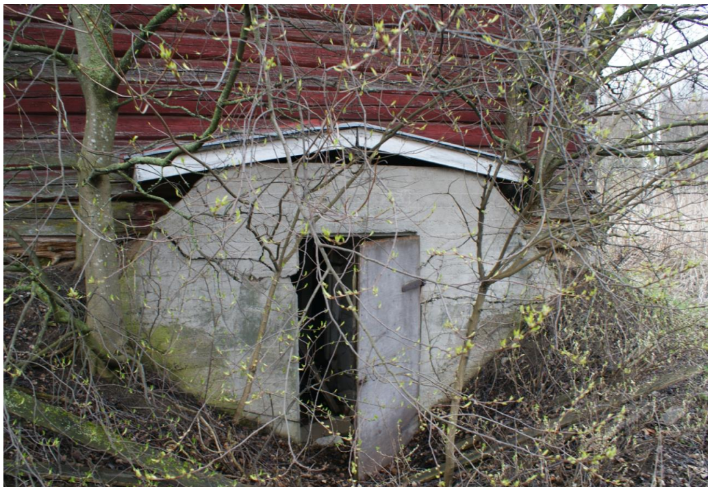
Kuva: maakellari, jonka etuseinä betonia (betonitiiltä), harjakatto. Sijaitsee "pikkuaitan" yhteydessä, sisäänkäynti aitan takana. Suullisen tiedon mukaan kellarin katto on romahtanut.
