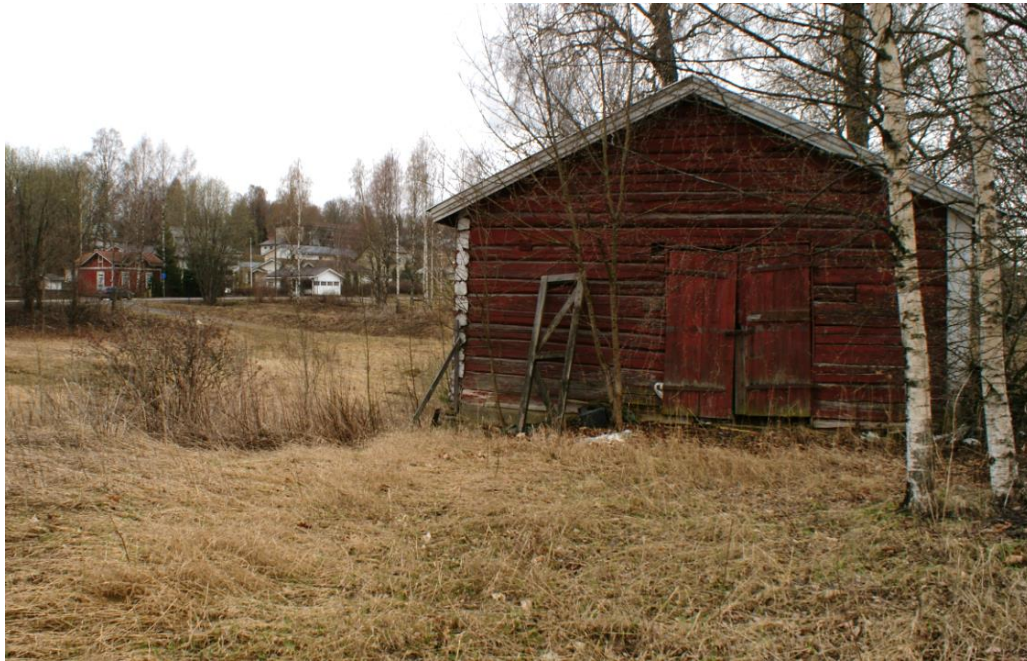
Kuva: Punamullattu matalahko, pitkänurkkainen aittarakennus, jonka alla on kellari. Sijaitsee hieman pihapiirin ulkopuolella. Peltikatto. Eteläseinän hirsissä on lahovaurioita.
