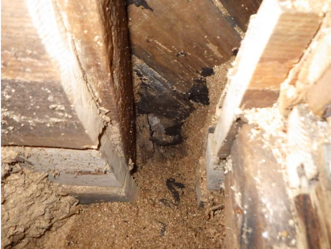
Kuva 12. Rakenneavaus US1. Rappauksen takana oleva laudoitus on lahoa seinän alalaidassa, lattian pinnan alapuolella.
