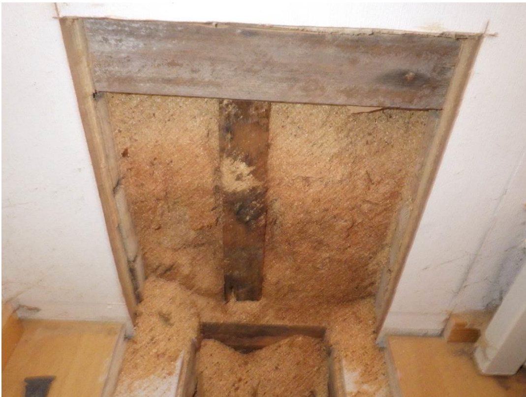
Kuva 11. Rakenneavaus US1. Purut seinän alaosassa ovat tummuneita.
