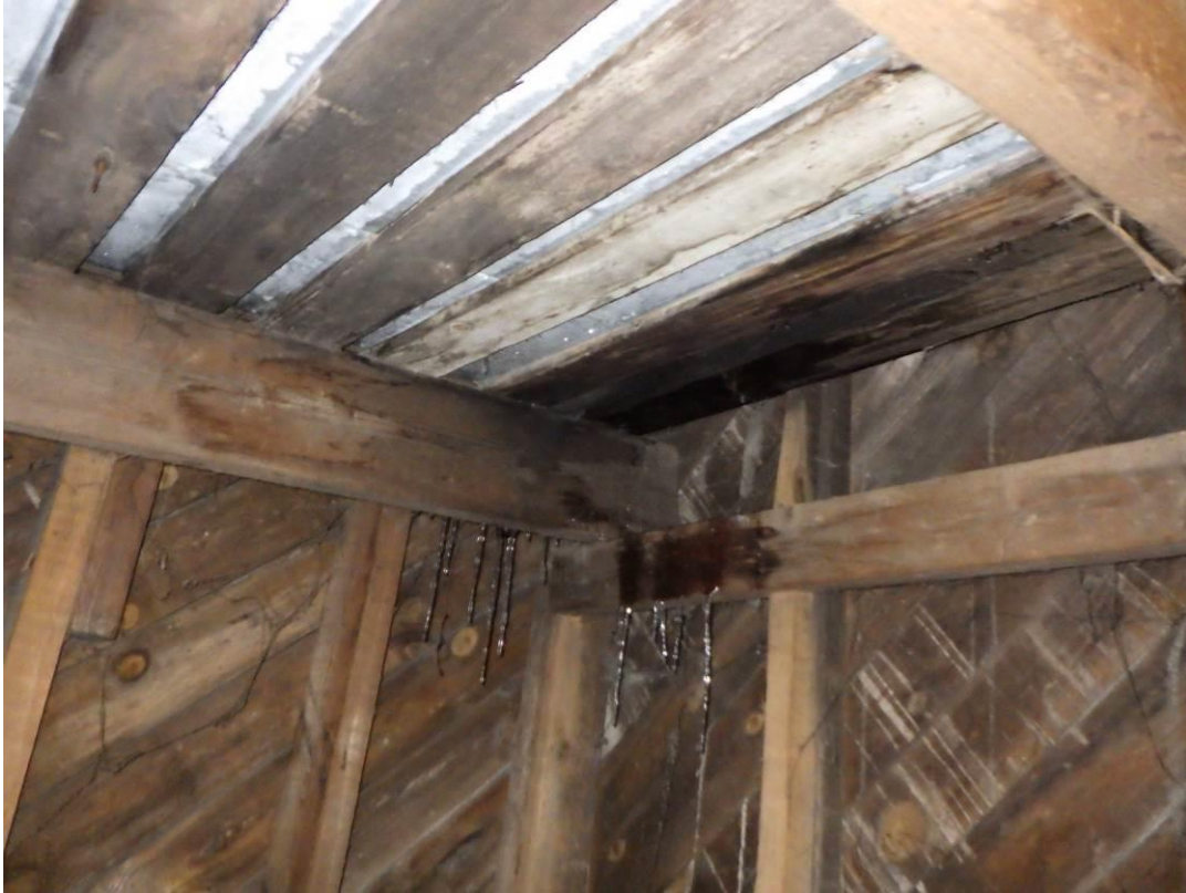
Kuva 21. Vesikatteen vuoto kohta yläpohjassa.
