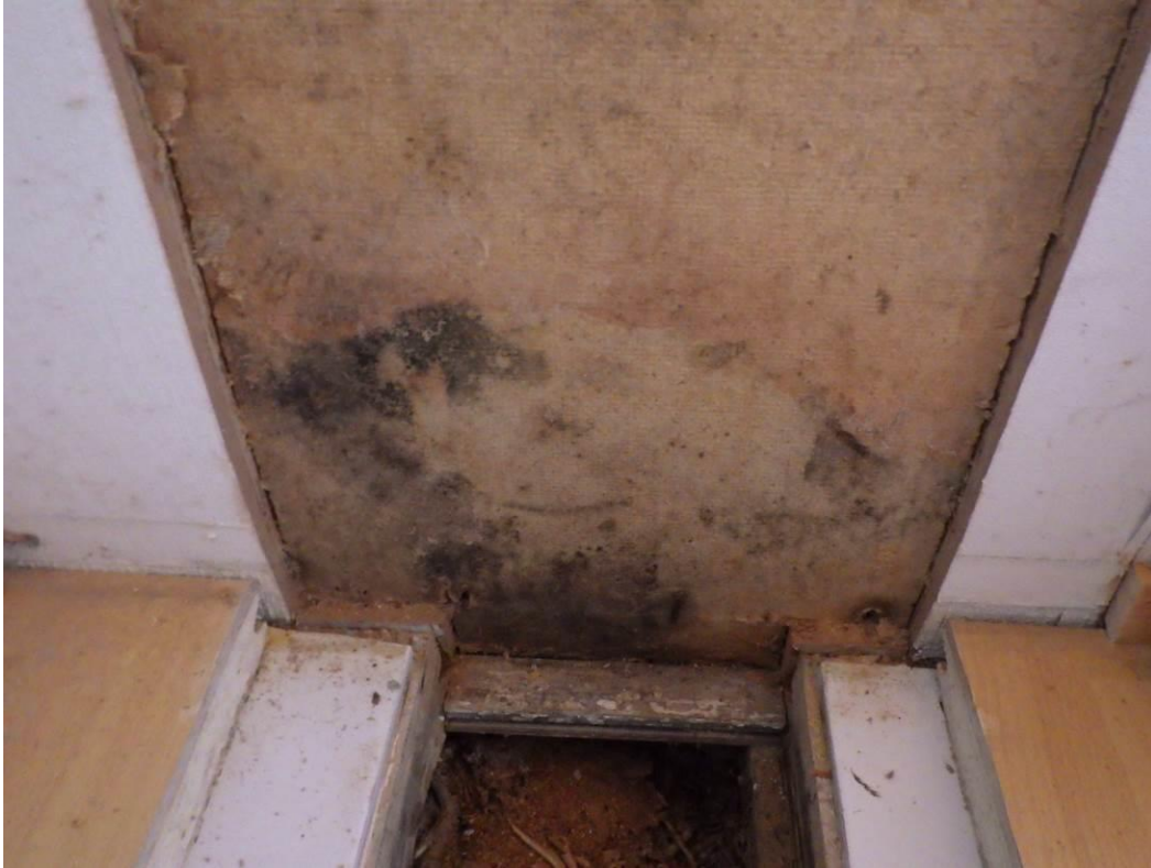
Kuva 10. Rakenneavaus US1. Sisäverhouslevyn takana olevassa levyssä on näkyvää mikrobikasvua.
