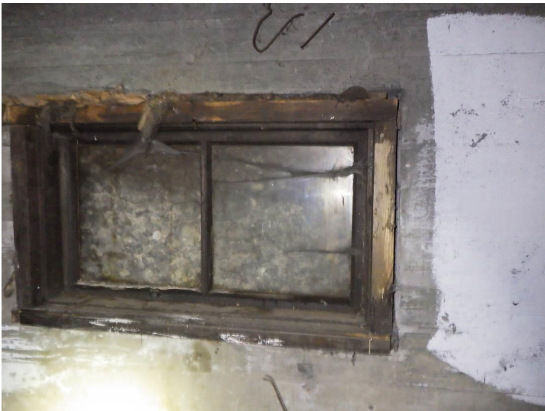
Kuva 5. Kellarikerroksen maanvastaista seinää kadun puolella. Ikkuna on jäänyt myöhemmin tehdyn maatäytön (kiviä/sepeliä) alapuolelle.
