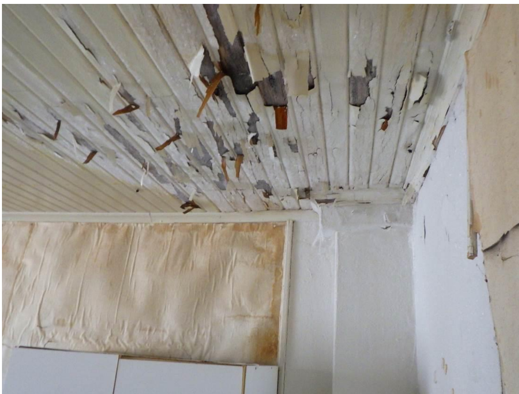
Kuva 20. Toisen kerroksen huoneiston katossa jälkiä vuodosta.
