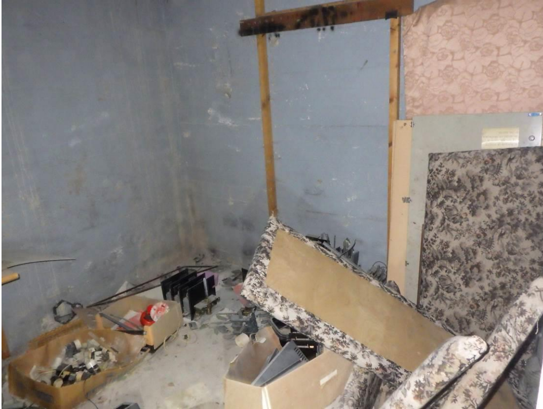
Kuva 4. Kellarikerroksen maanvastaista seinää. Seinän alaoissa näkyy jälkiä kosteudesta.
