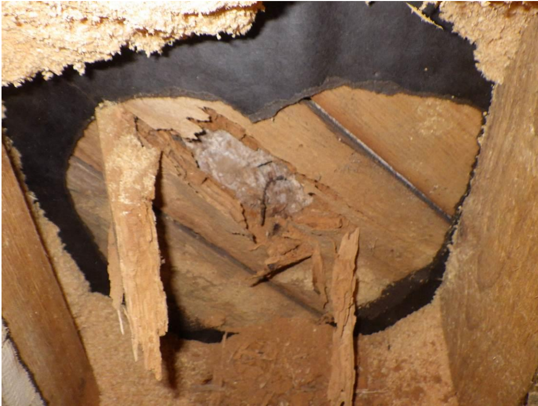
Kuva 14. Rakenneavaus US2. Ulompi laudoitus on lahonnut lattian pinnan yläpuolelta.
