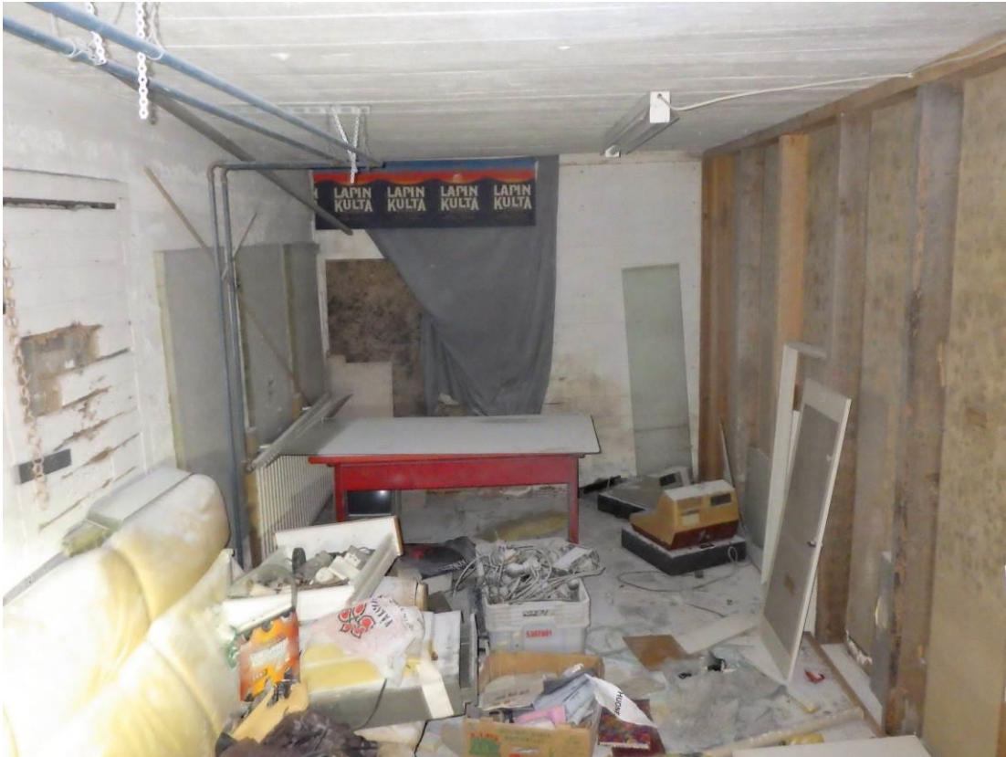
Kuva 6. Kellarikerroksen maanvastaista seinää kadun puolella. Seinän alalaidassa näkyy jälkiä kosteudesta.
