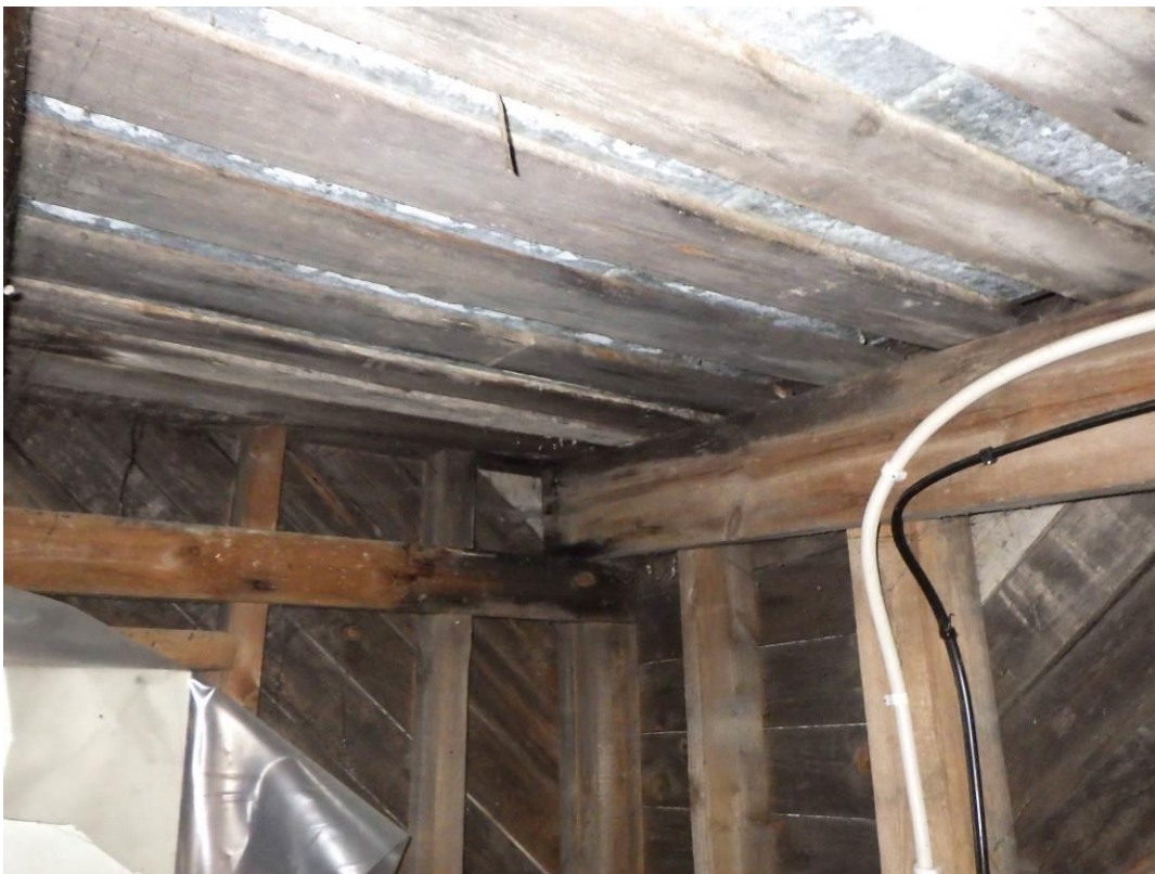
Kuva 22. Kosteus jälkiä yläpohjassa.
