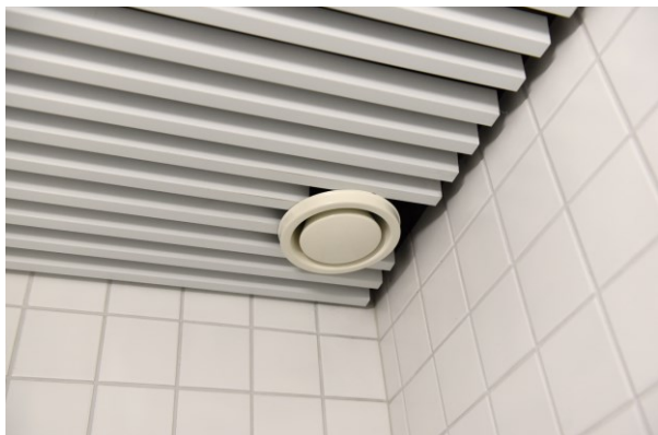
SÄLEIKKÖ ALAKATTONA; POISTOILMAVENTTIILI
