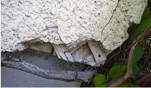
Halkeilevan julkisivurappauksen alta on paljastunut lautarakennetta.
